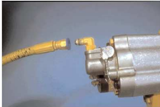
Fig. 3.2.46 Tubería de refuerzo del turbocompresor desconectada
