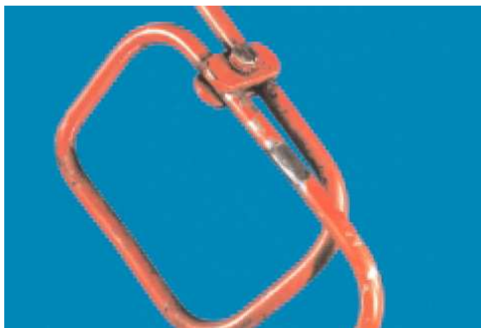
Fig. 2.3.14 Abrazaderas flojas de la tubería de combustible.
